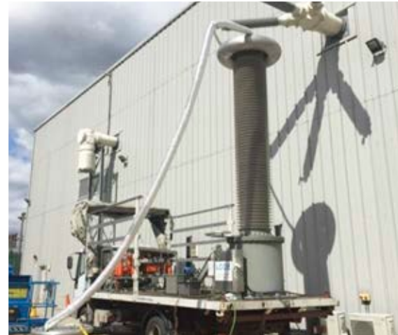
Conexión del transformador patrón del LCOE en el exterior de la subestación mediante un pasamuros.
