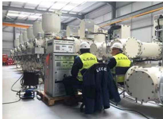
Técnicos del LCOE realizan la verificación en el interior de la subestación.
