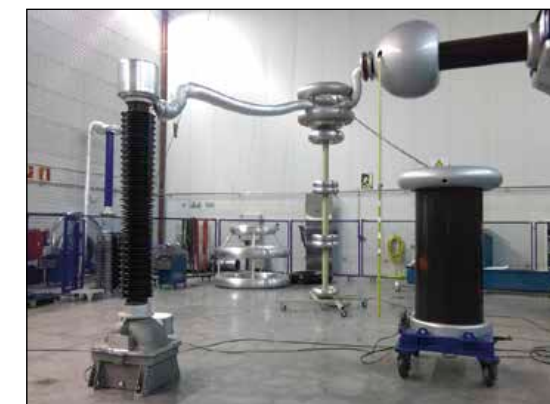
Ensayo de precisión sobre transformador de tensión de 245 kV.
